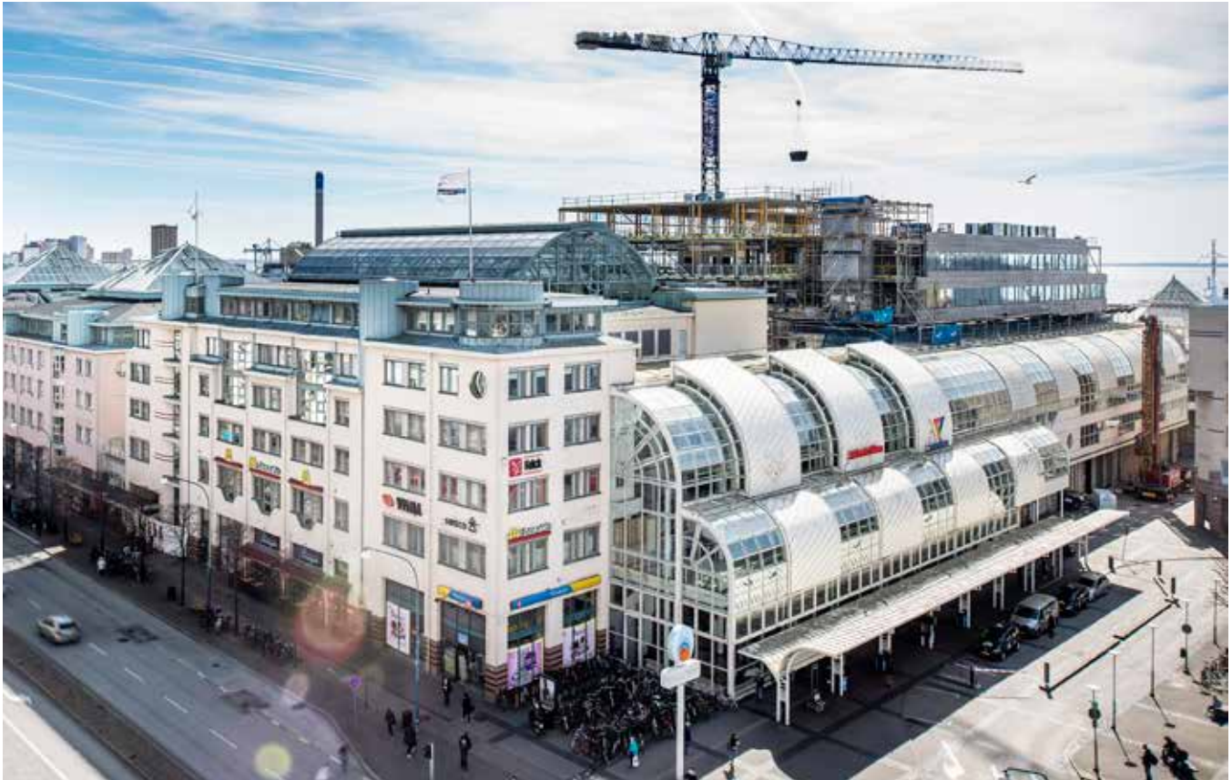
På Knutpunkten i Helsingborg växer den nya delen fram och fasadpartierna börjar komma på plats. I första etappen byggs 7 700 m 2 kontor med utsikt över sundet och takåsarna i centrum. I kommande etapper ska bland annat resecentret byggas om.
