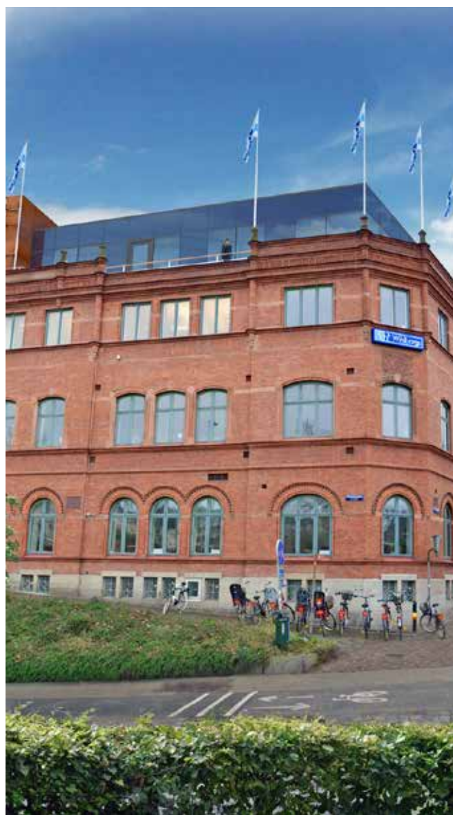
På taket till Armaturen 4 utförs en tillbyggnad om 1 000 m 2 till fantastiska kontorslokaler med utsikt över Lund.
